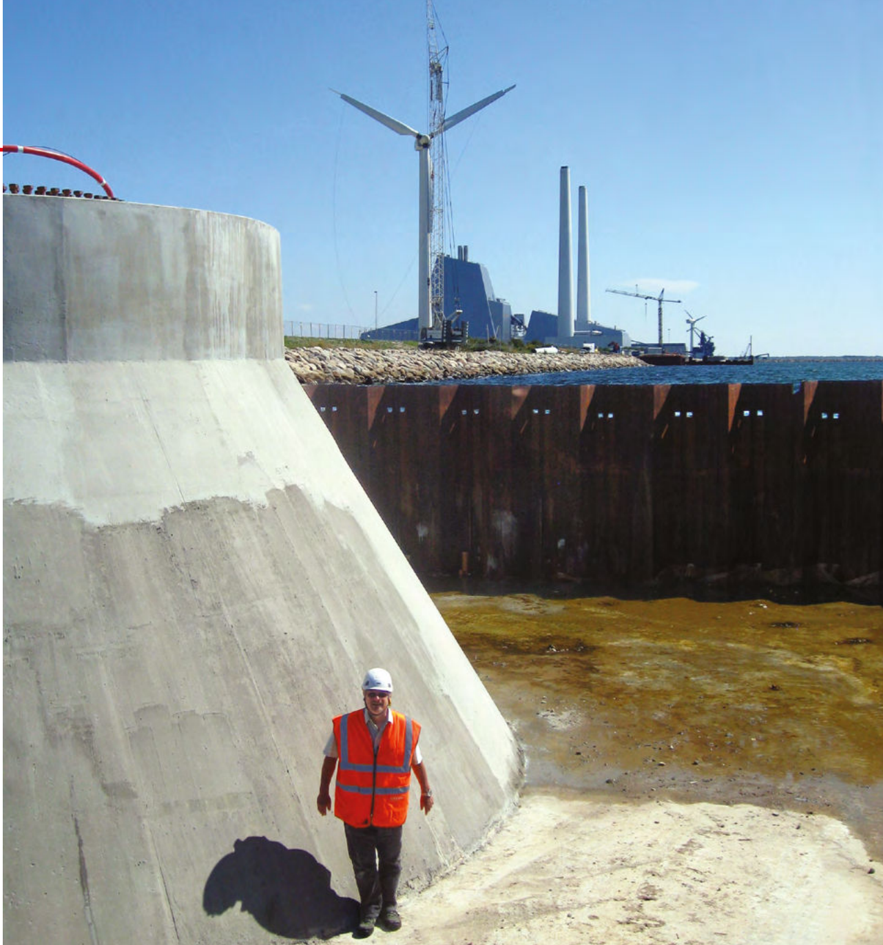
Fundament til ny Siemens Wind Power 3,6 MW mølle ved Avedøre Holme. Udfordring til nedrivningsteknik om 20-30 år når møllen er udtjent
