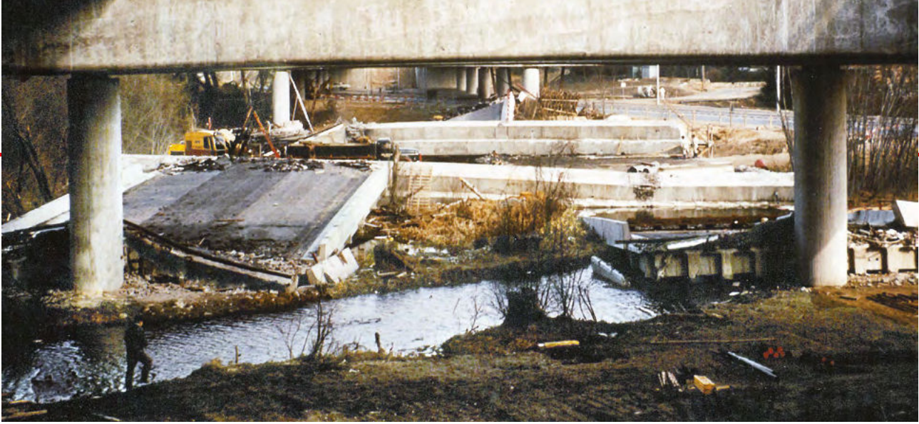
Den nye motorvejsbro ved Fiskebæk styrtede sammen kort efter at den var færdig og før den blev taget i brug, 1972. Sammenstyrtningen skyldes svigtende fundering. Den ødelagte brokonstruktion blev fjernet ved sprængning
