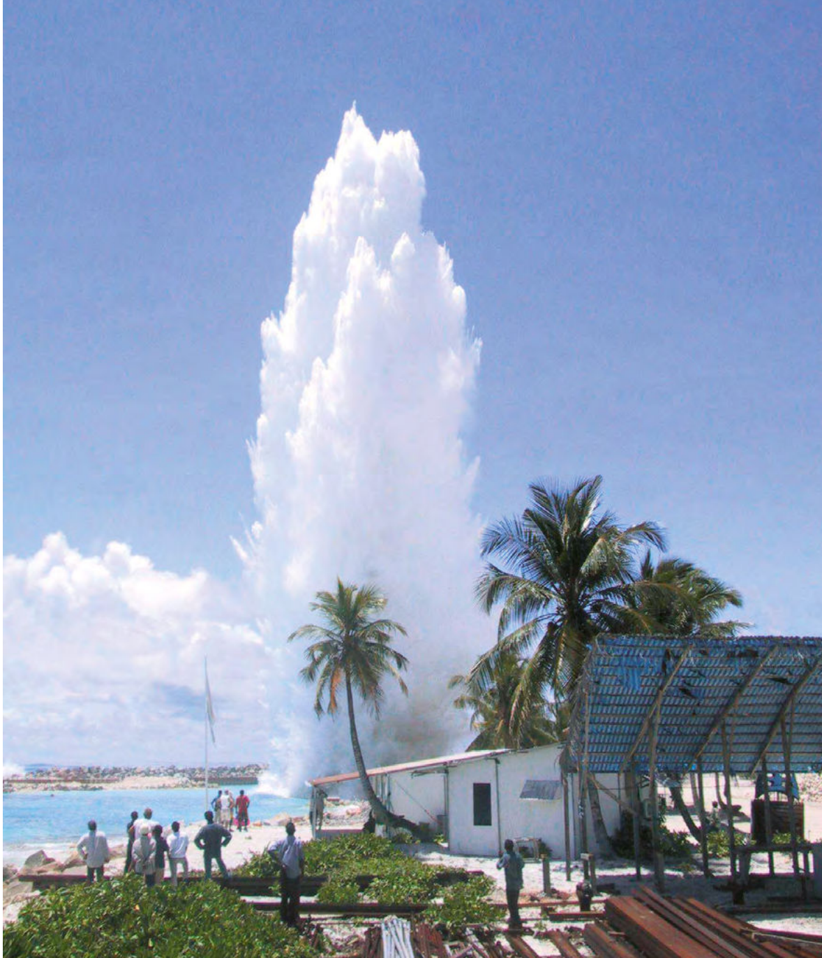
Bygning af ny fiskerihavn og sprængning af koraler for at opnå tilstrækkelig vanddybde, Fuah Mulaku Harbour Project, Maldiverne 2000-2002
