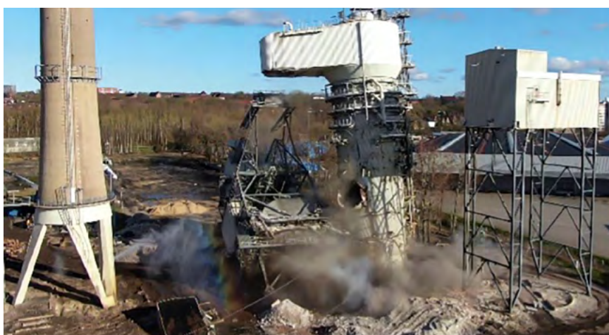
Abb. 3: Gasvorwärmer li. - Kohlewäscher re.
